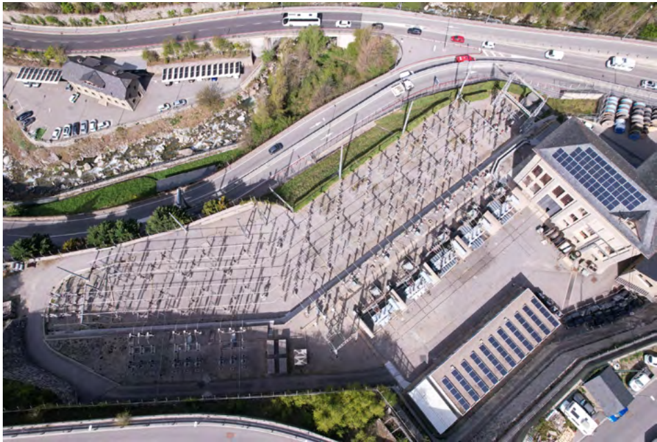
Instal·lacions fotovoltaiques a l'ETR d'Encamp.
